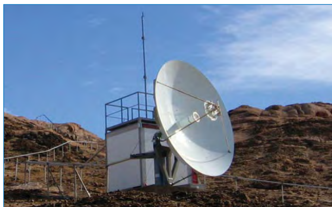
Общий вид земной спутниковой станции связи на станции Прогресс.
