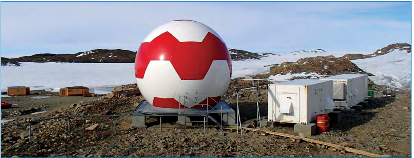
Новые комплексы оборудования системы ГЛОНАСС на станции Новолазаревская. Фото В.Е. Кораблева
